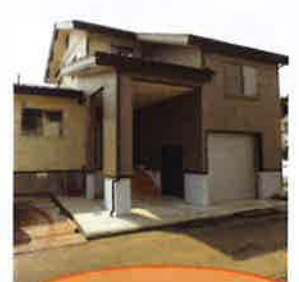
劣化による塗装
